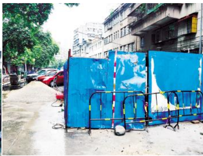
←清城区上、下廓街工程部分工段未按要求设置围挡。
